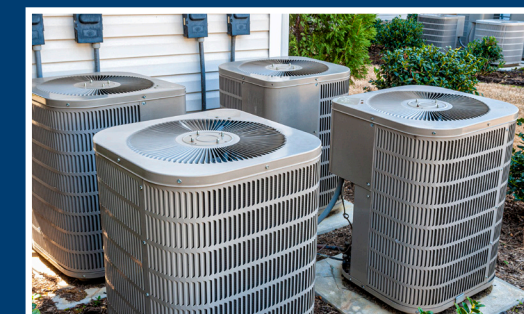
HVAC CVC Climatización
