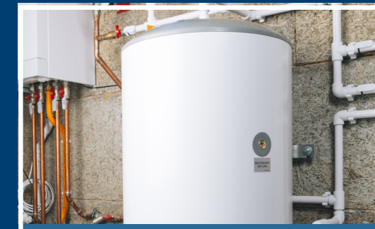
WATER HEATER Chauffe-eau Calentador de Agua
