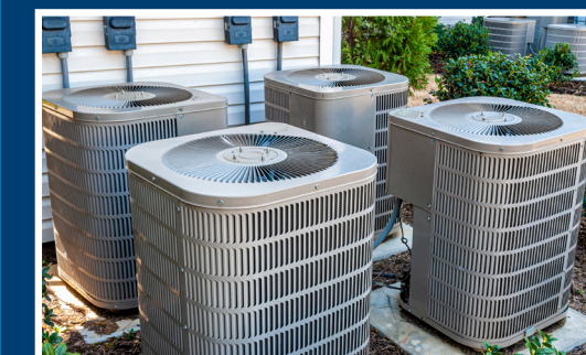
HVAC CVC Climatización
